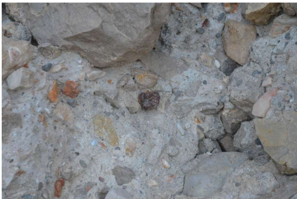
A.M.G. 008. Fotografia de detall. Argamassa i vareta de ferro. Casamata l'Escullera Nord.
